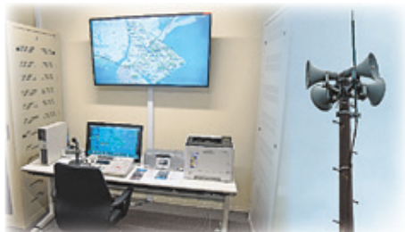
市役所の基地局と屋外スピーカー（現在）
