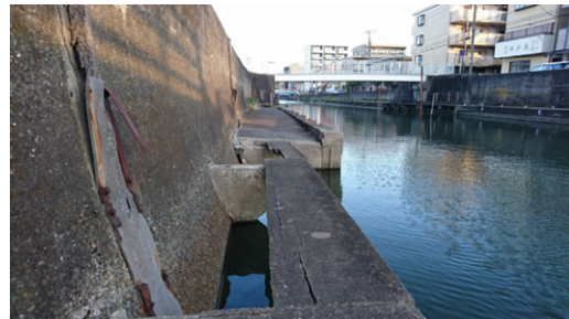
図7 元町地域の老朽化箇所
