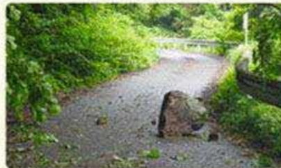
かけ・落石のおそれがあるところ
