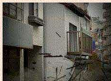
強い揺れによる 建物崩壊
