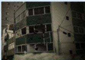
強い揺れによる 建物崩壊
