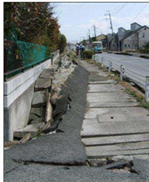
③地中の水道管が破損
