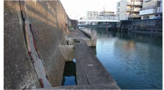
図7 元町地域の老朽化箇所
