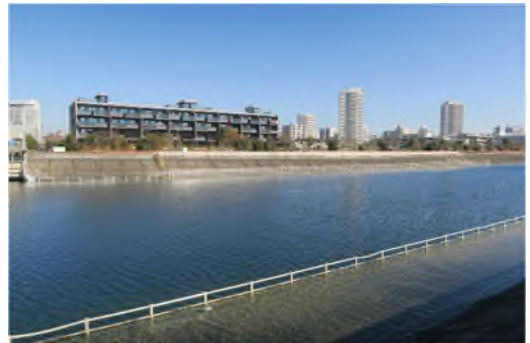
図9 新町地域の護岸（小段）水没箇所
