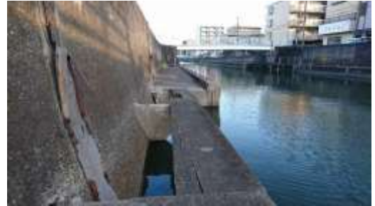
図7 元町地域の老朽化箇所
