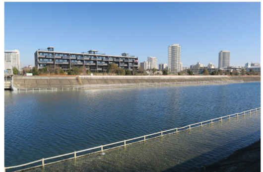
図9 新町地域の護岸（小段）水没箇所
