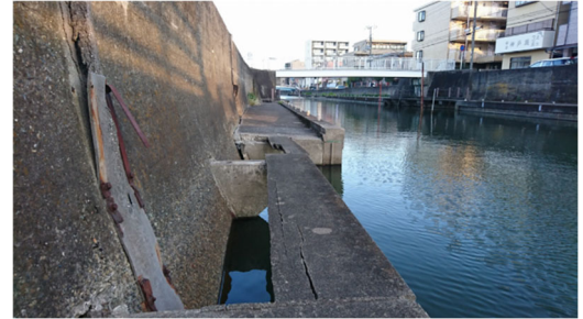
図7 元町地域の老朽化箇所
