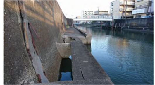
図7 元町地域の老朽化箇所
