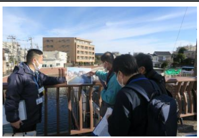
Bゾーン（新橋下流側） 緩傾斜護岸（階段形状の護岸） 工事現場
