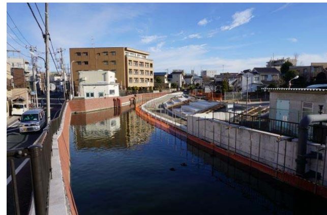
Bゾーン（新橋下流側） 緩傾斜護岸（階段形状の護岸） 工事現場
