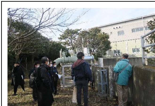
D1-1ゾーン 境川排水機場 (雨量局・浄化ポンプ)
