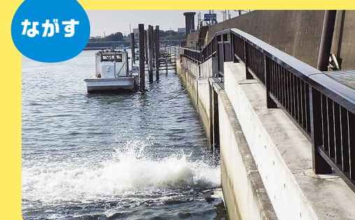
旧江戸川当り島地区の護岸にある吐き出し管
