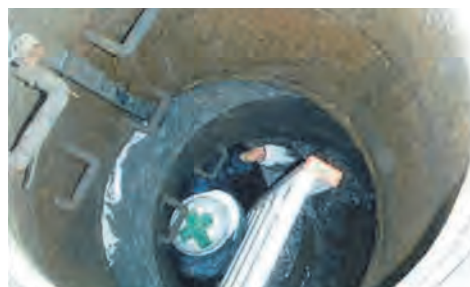
マンホールの躯体ズレ
