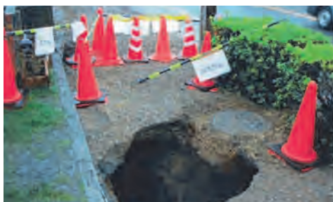
マンホール近傍の道路陥没
