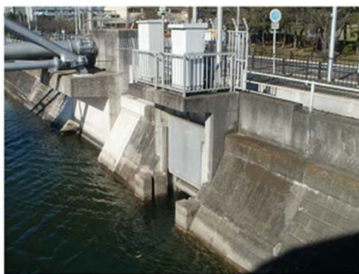
写真 5-1 No10 アルミ製スライドゲート
