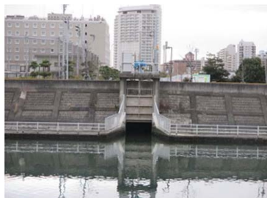
写真 5-2 No34 ステンレス製スライドゲート
