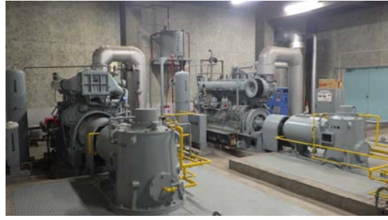
写真 2-2 当代島排水機場(施設内)
