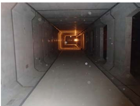
写真 2-7 見明川小学校貯留槽
