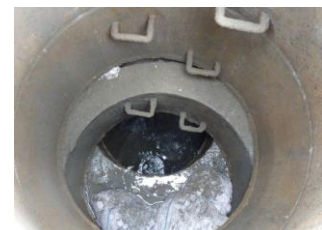
マンホール躯体のずれ
