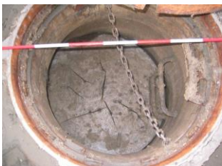
土砂流入による枝管の閉塞状況
