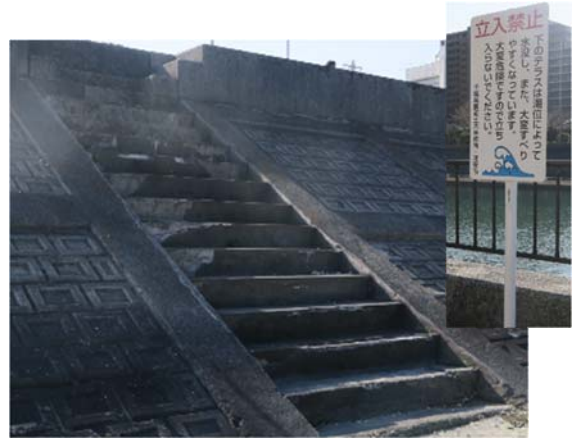
写真 4.21 ②小段への階段、進入禁止
