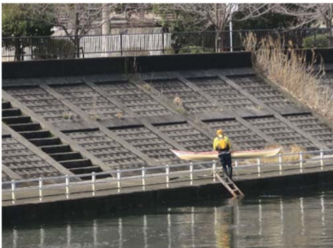
写真 4.22 ③小段～水面のアクセス未整備 (梯子利用)
