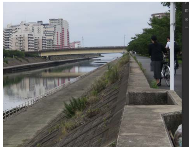
写真 4.23 ④入船橋～高洲橋間 転落防止柵が無く危険
