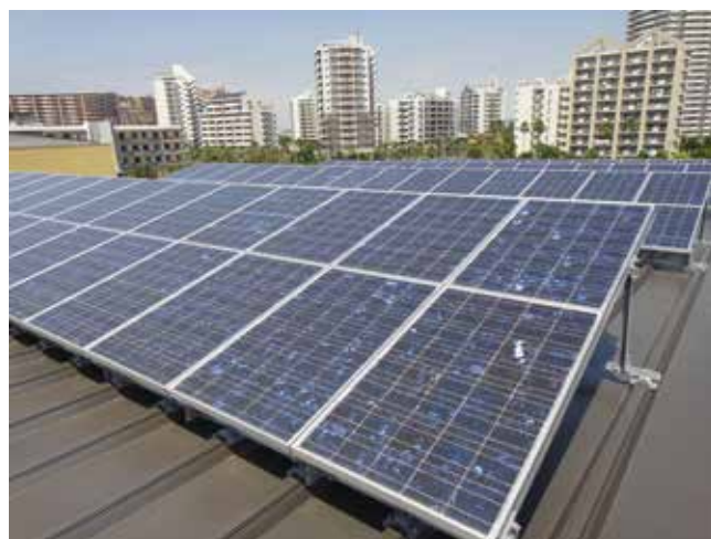
太陽光発電設備
