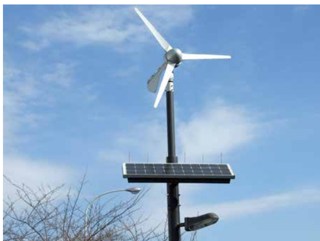
太陽光・風力発電設備
