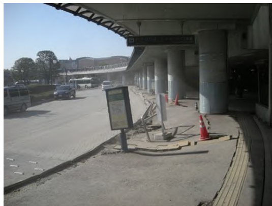
写真-5 舞浜駅前の被害写真
