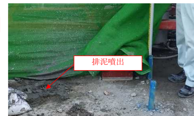
写真 1-16 排泥噴出状況 (No. 4)
