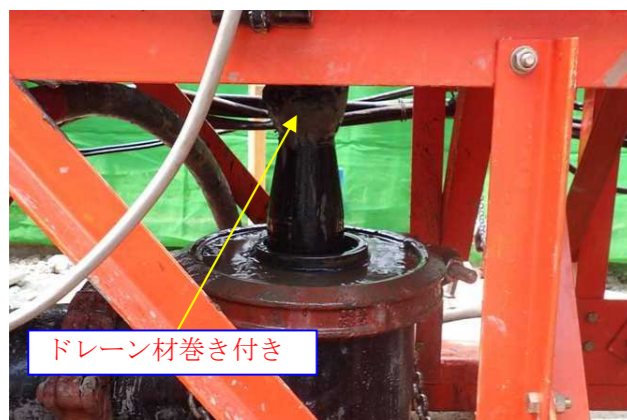
写真 1-1 埋設物の巻き付き状況
