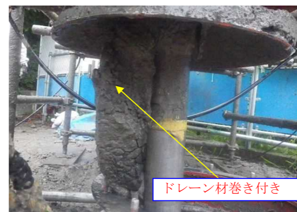
写真 1-3 埋設物の巻き付き状況
