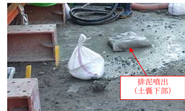
写真 1-18 排泥噴出状況 (No. 10)
