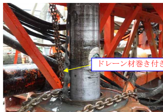
写真 1-11 埋設物の巻き付き状況
