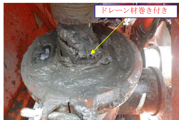
写真 1-9 埋設物の巻き付き状況
