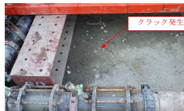
写真 1-15 クラック発生状況 (No. 4)
