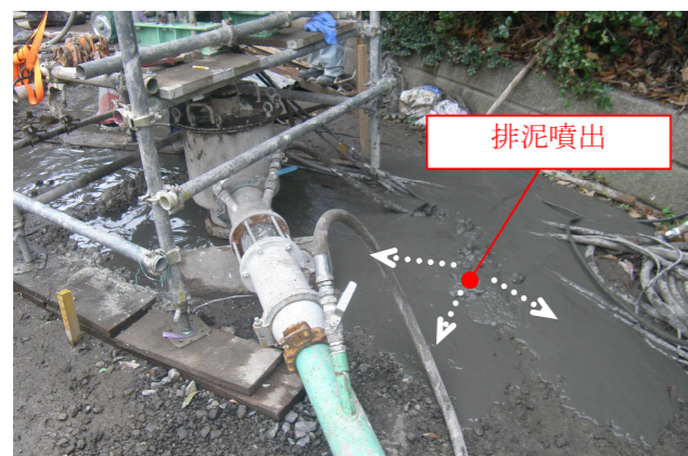
写真 1-13 排泥噴出状況 (No. 7)
