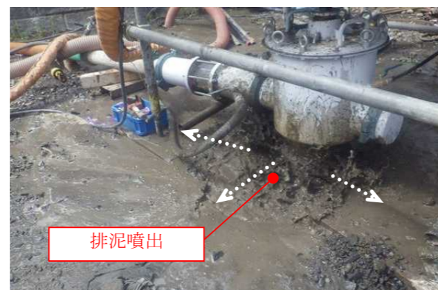
写真 1-14 排泥噴出状況 (No. 9)
