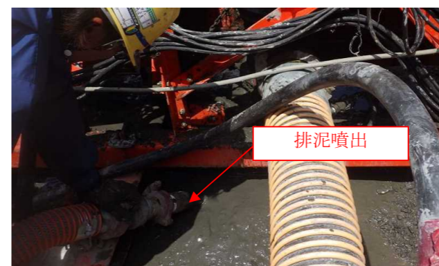
写真 1-17 排泥噴出状況 (No. 6)
