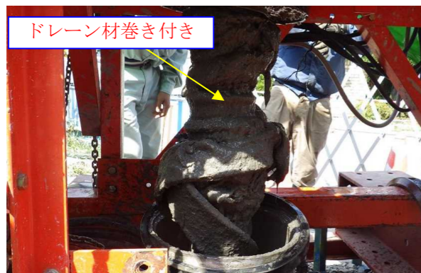
写真 1-5 埋設物の巻き付き状況
