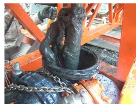
写真 1-13 ドレーン材の巻き付き状況
