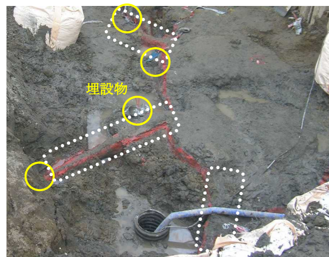
写真2-18 セメントスラリーの逸走状況
