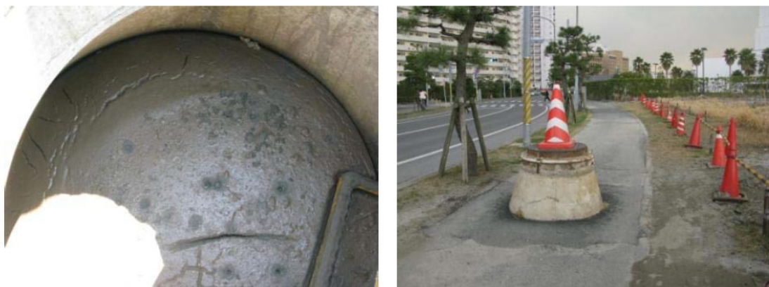
(a) マンホールの閉塞
