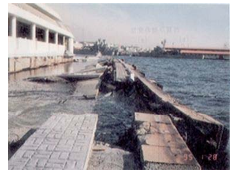
図-3.1.4 格子状地盤改良で液状化対策されていた建物 (阪神大震災時に被害なし、隣接する無対策の岸壁は液状化により崩壊)
