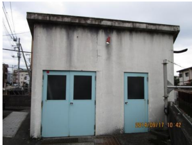
山城屋前排水機場
