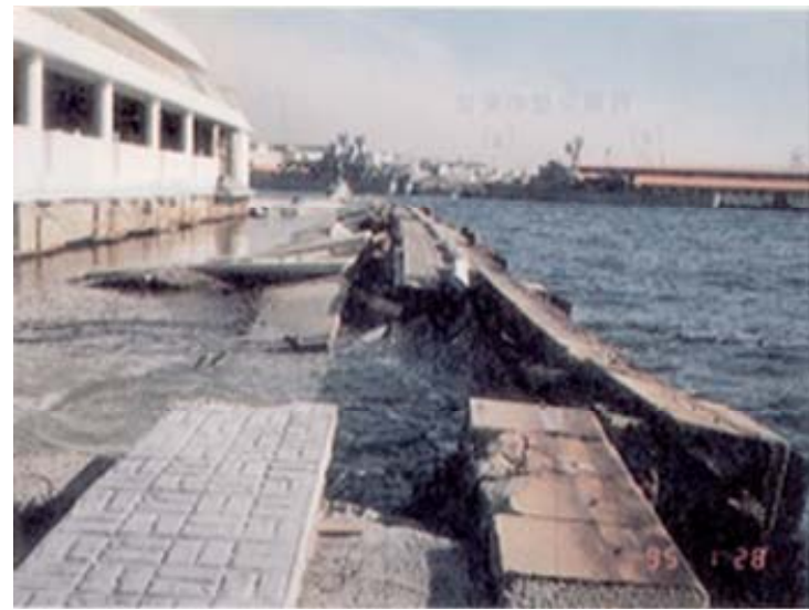
図-1.4 格子状地盤改良で液状化対策されていた建物 (阪神大震災時に被害なし、隣接する無対策の岸壁は液状化により崩壊)
