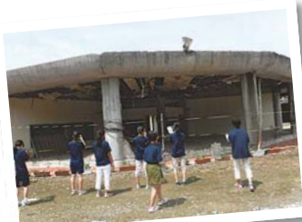
津波により大きな被害を受けた大川小学校跡
