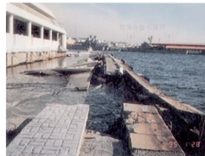
図-1.4 格子状地盤改良で液状化対策されていた建物 (阪神大震災時に被害なし、隣接する無対策の岸壁は液状化により崩壊)
