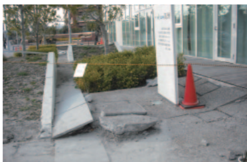
生涯学習施設も大きな被害を受けました。(エスレ高洲の被害の様子)
