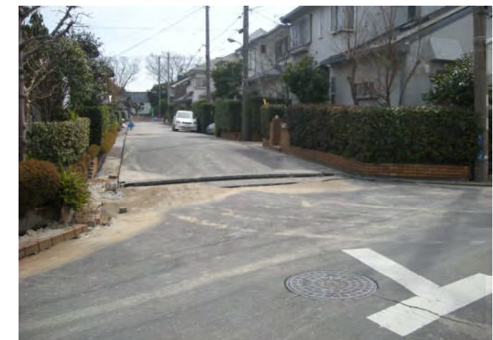
道路被害小（被災程度例）
