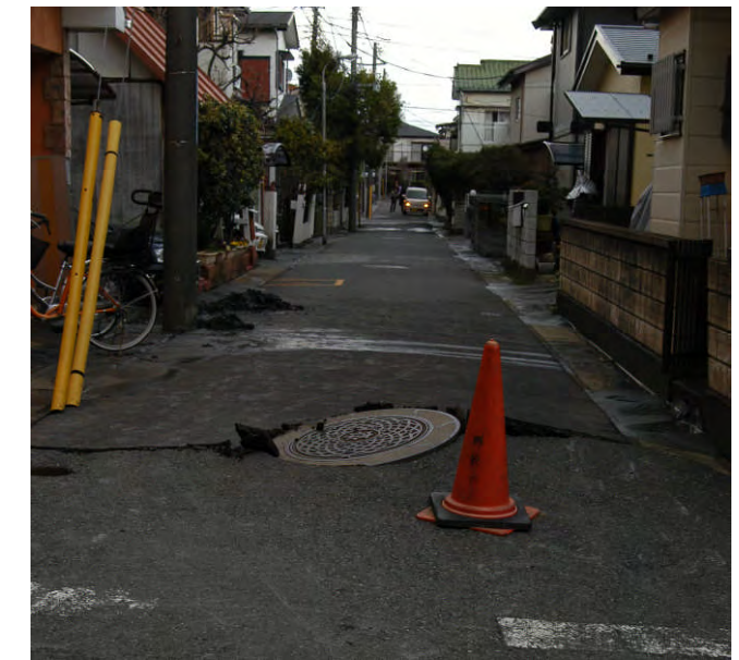
道路被害中（被災程度例）
