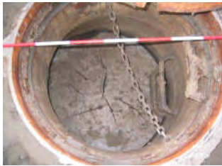
土砂流入による枝管の閉塞状況
