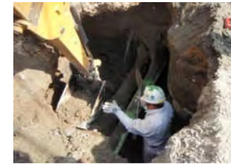
躯体のずれによる道路陥没応急復旧状
