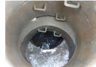
マンホール躯体のずれ
