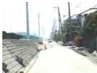
旧護岸の変状に伴う隆起 3 6-77号線(今川)
