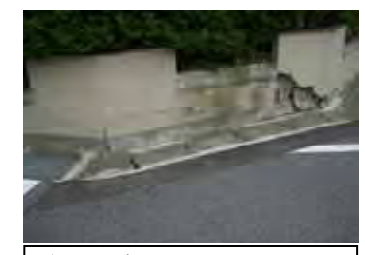
宅地の沈下 8 7-26号線(東野)
