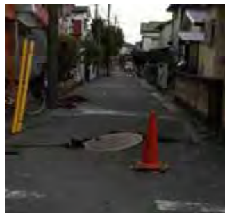
道路被害中（被災程度例）
