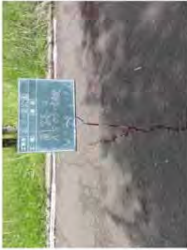
写真 4-2 高洲中央公園の被災状況
