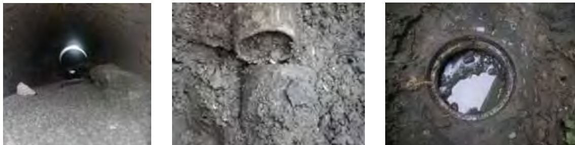
写真 1.3-1 宅内排水設備の被害写真（左から継手ズレ、脱却、土砂流入）
