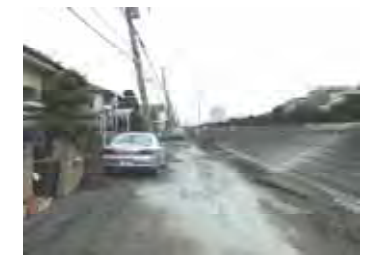
旧護岸の変状に伴う隆起 4 6-77号線(今川)
