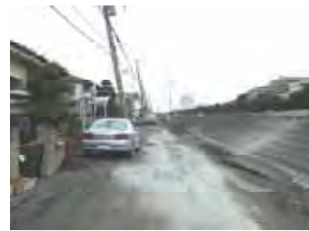
旧護岸の変状に伴う隆起
