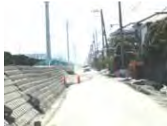
旧護岸の変状に伴う隆起
