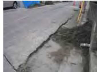
宅地の沈下に伴うひび割れと噴砂
