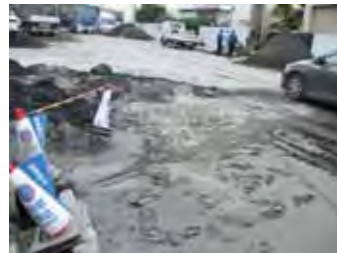
地盤の相対的な動きによる迫上がり
