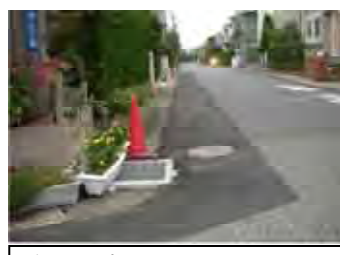
宅地の沈下 7 7-26号線(東野)
