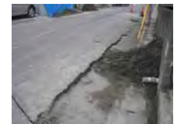
宅地の沈下に伴うひび割れ と噴砂 6 5-12号線(美浜)
