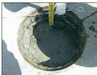
土砂で閉塞したマンホール
