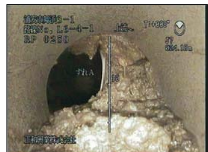
継手がズレ、管路に土砂が流入
