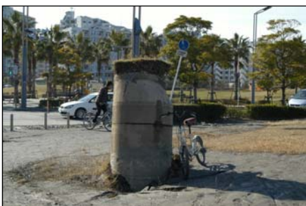
浮上したマンホール
