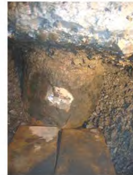
写真-2.2.1 杭頭周辺部の地盤の状況 (入船南小学校)
