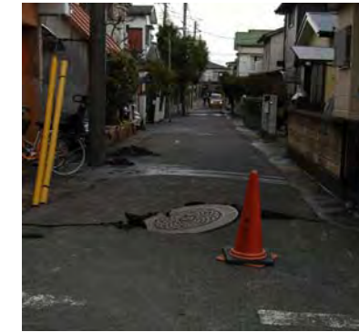
道路被害中（被災程度例）
