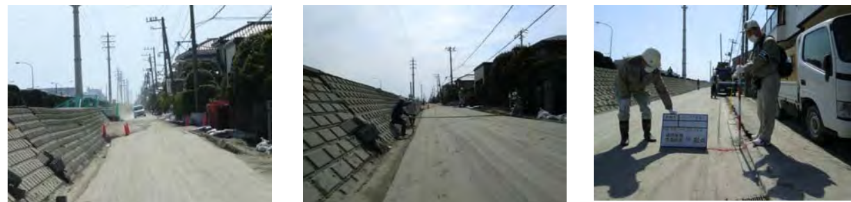
旧護岸の変状に伴う隆起
