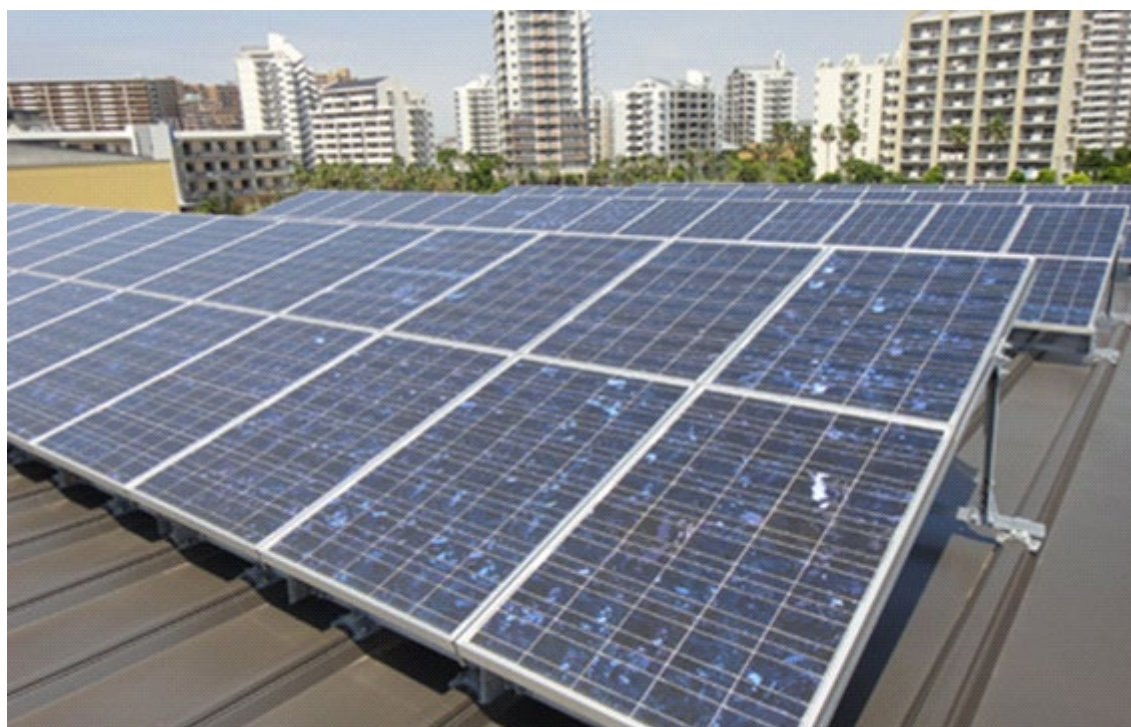
<公共施設に設置しているソーラーパネル>
