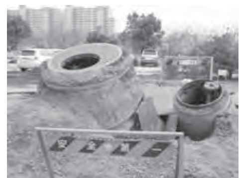
高洲中央公園 (耐震性貯水槽)
