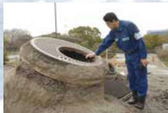
東日本大震災でせりあがったマンホール 液状化による建物の傾き、ライフラインの断絶など広範囲で、大きな被害を受けました。
