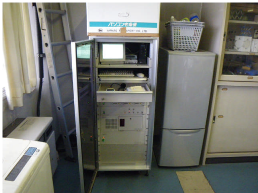
高洲 騒音測定器本体設置状況
