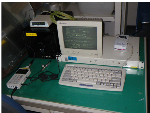
千鳥 騒音測定器本体設置状況
