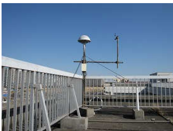
高洲 航空機識別センサー設置状況
