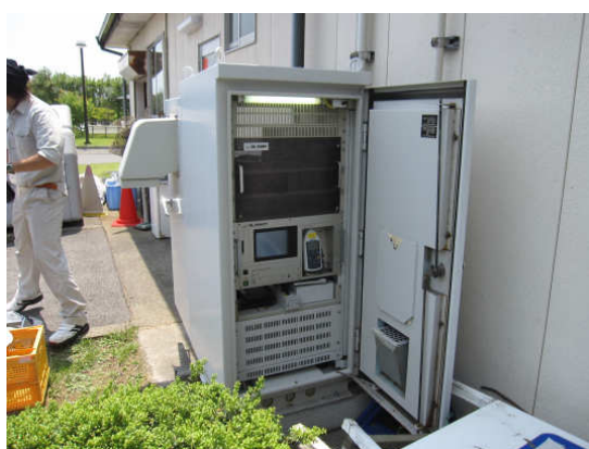
日の出 騒音測定器本体設置状況
