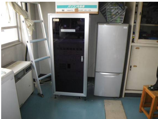
高洲 騒音測定器本体設置状況
