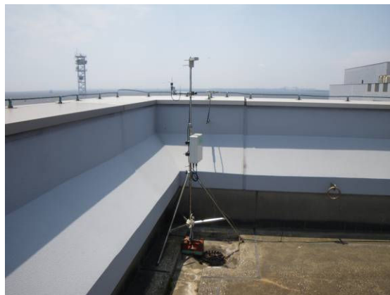
千鳥 航空機識別センサー設置状況
