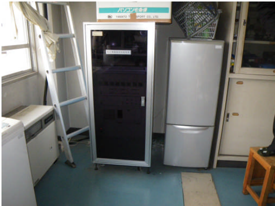
高洲 騒音測定器本体設置状況
