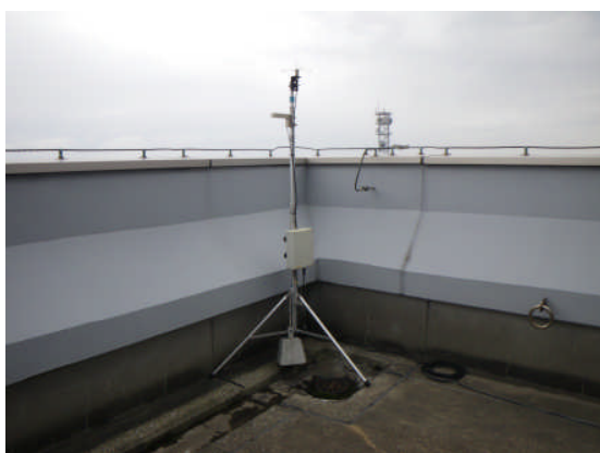
千鳥 航空機識別センサー設置状況
