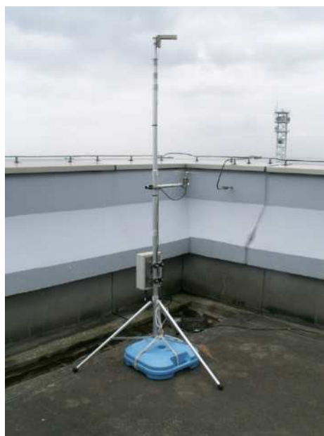
航空機接近検知識別センサー
