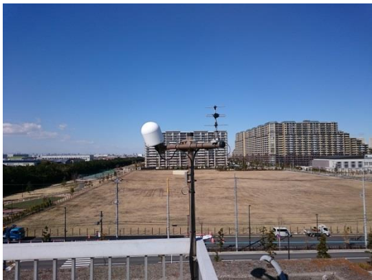
高洲 航空機識別センサー設置状況
