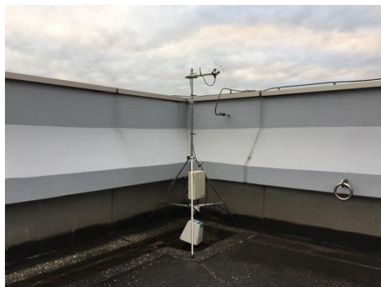
千鳥 航空機識別センサー設置状況
