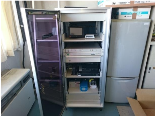
高洲 騒音測定器本体設置状況
