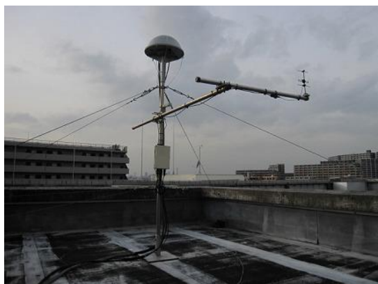
当代島 航空機識別センサー設置状況
