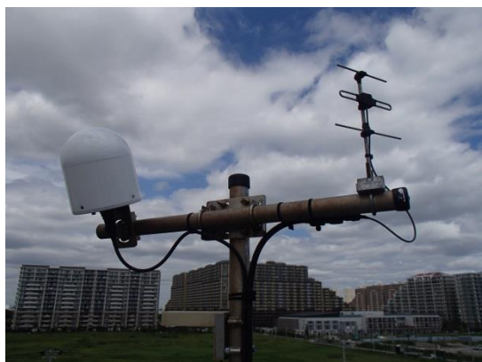
高洲 航空機識別センサー設置状況
