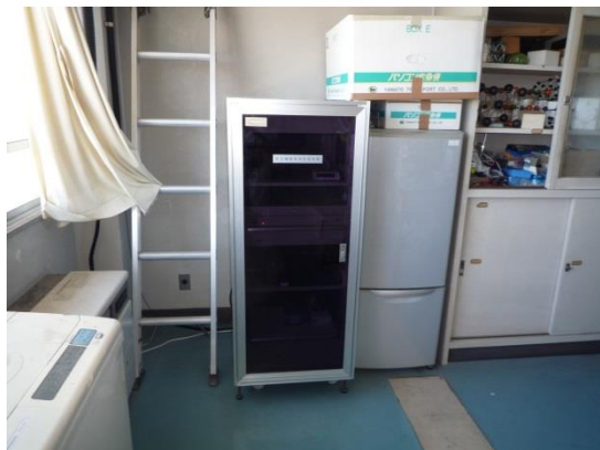
高洲 騒音測定器本体設置状況
