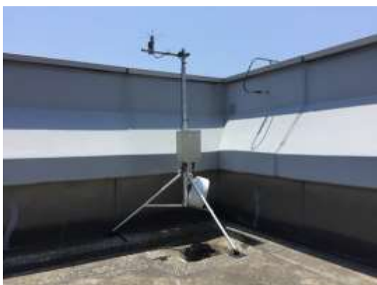
千鳥 航空機識別センサー設置状況
