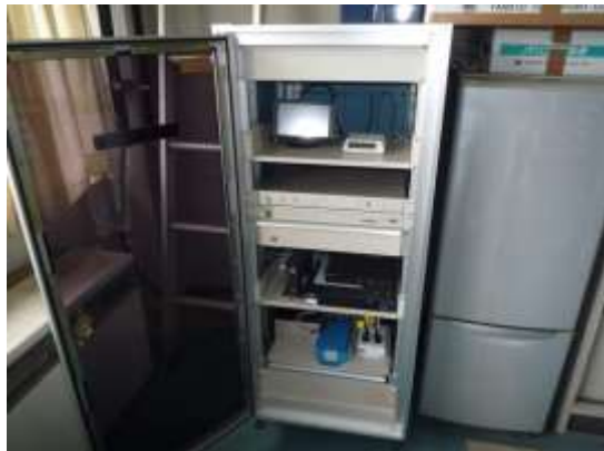
高洲 騒音測定器本体設置状況
