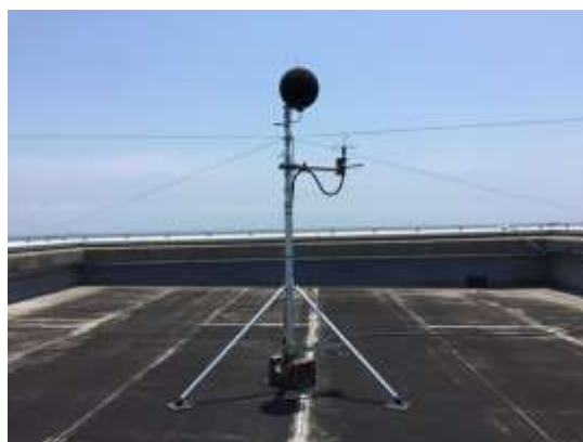
千鳥 マイクロホン及び ADSB 受信装置センサー設置状況
