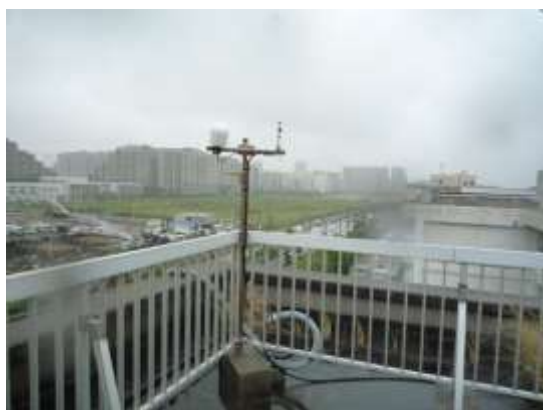
高洲 航空機識別センサー設置状況
