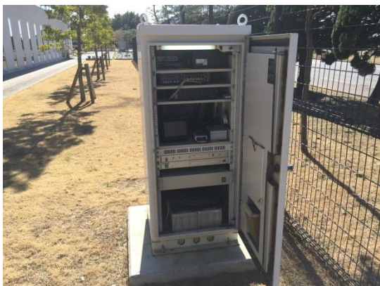
日の出 騒音測定器本体設置状況
