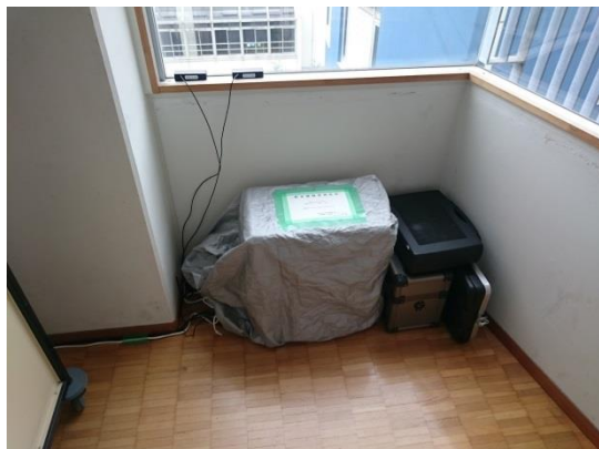
明海 騒音測定器本体設置状況
