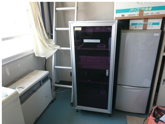
高洲 騒音測定器本体設置状況
