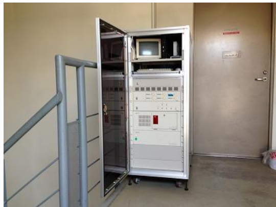
当代島 騒音測定器本体設置状況
