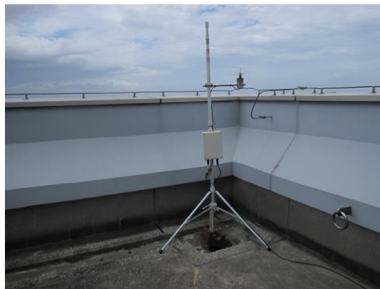
千鳥 航空機識別センサー設置状況
