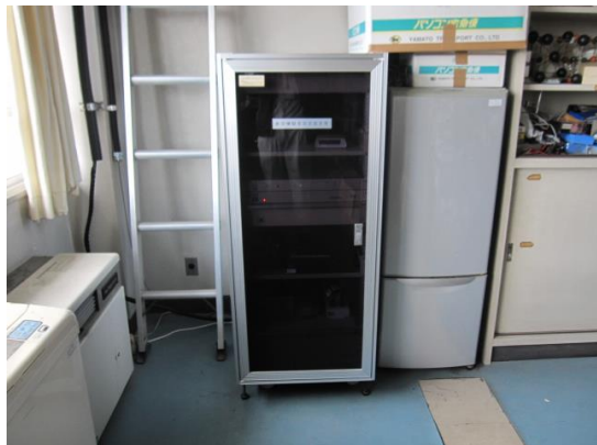
高洲 騒音測定器本体設置状況
